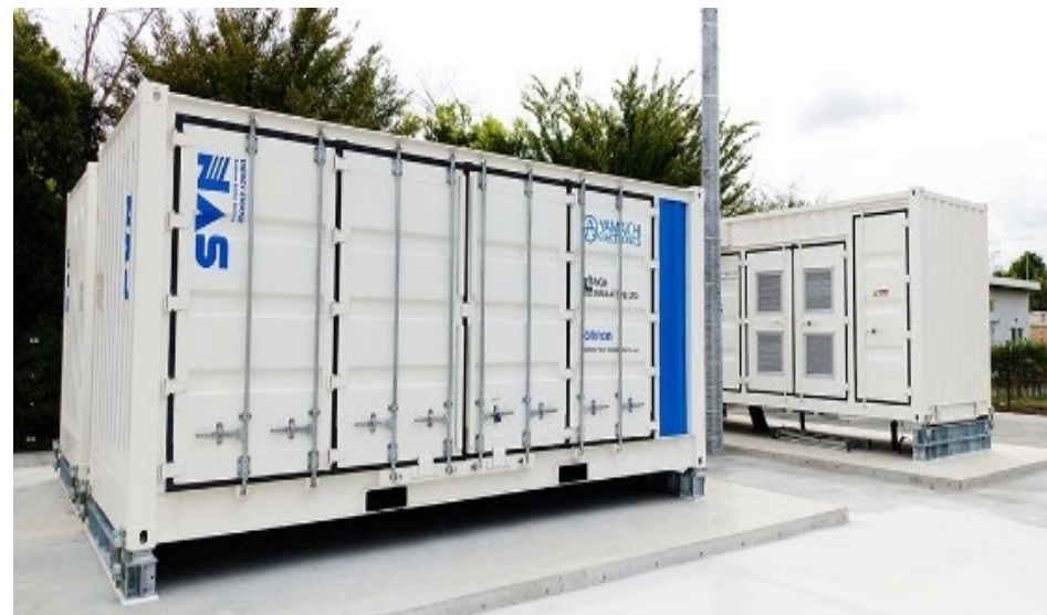
佐倉事業所 NAS電池システム 容量2,400kWh 出力400kW
