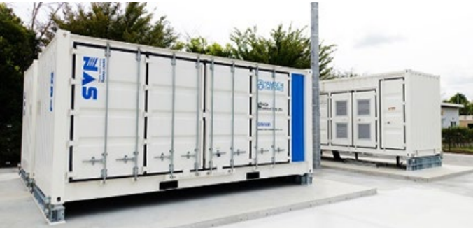
佐倉事業所 NAS電池システム
